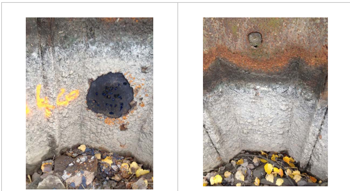
Figure 4 : Photographies du phénomène de corrosion observé sur les palplanches
