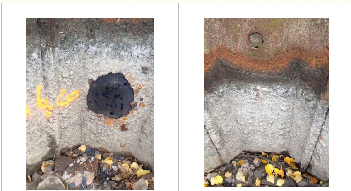
Figure 5 : Photographies du phénomène de corrosion observé sur les palplanches
