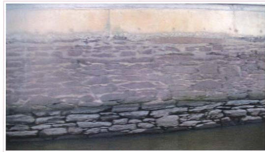
Culée C0 rive gauche – Disjointoiement de la maçonnerie Photo : 3
