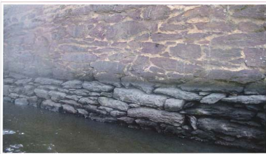
Culée C0 rive gauche – Disjointoiement de la maçonnerie Photo : 4
