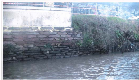
Culée C0 rive gauche – Disjointoiement de la maçonnerie Photo : 5
